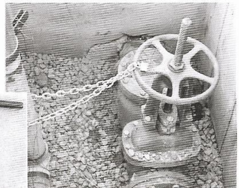
Figura 11.13 Algunas cajas de válvulas están bajo tierra.
