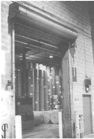
Figura 8.40 Puerta cortafuegos de acero enrollable ascendente.
