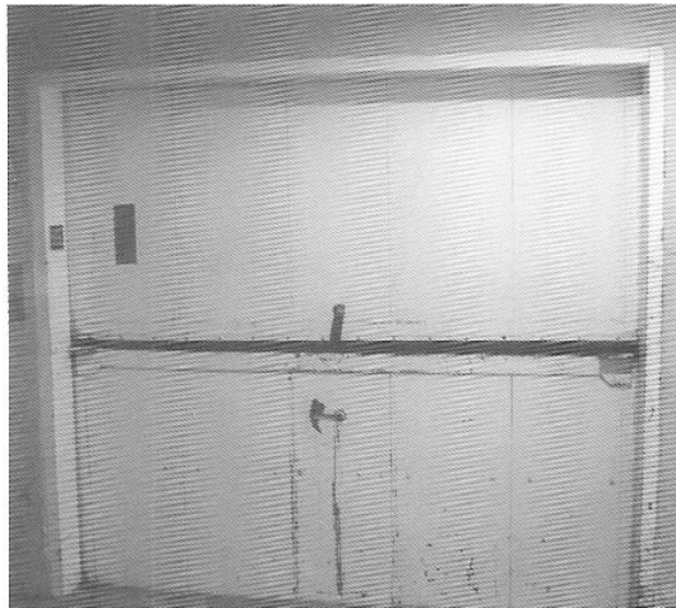
Figura 8.42 Una puerta cortafuegos contrabalanceada.
